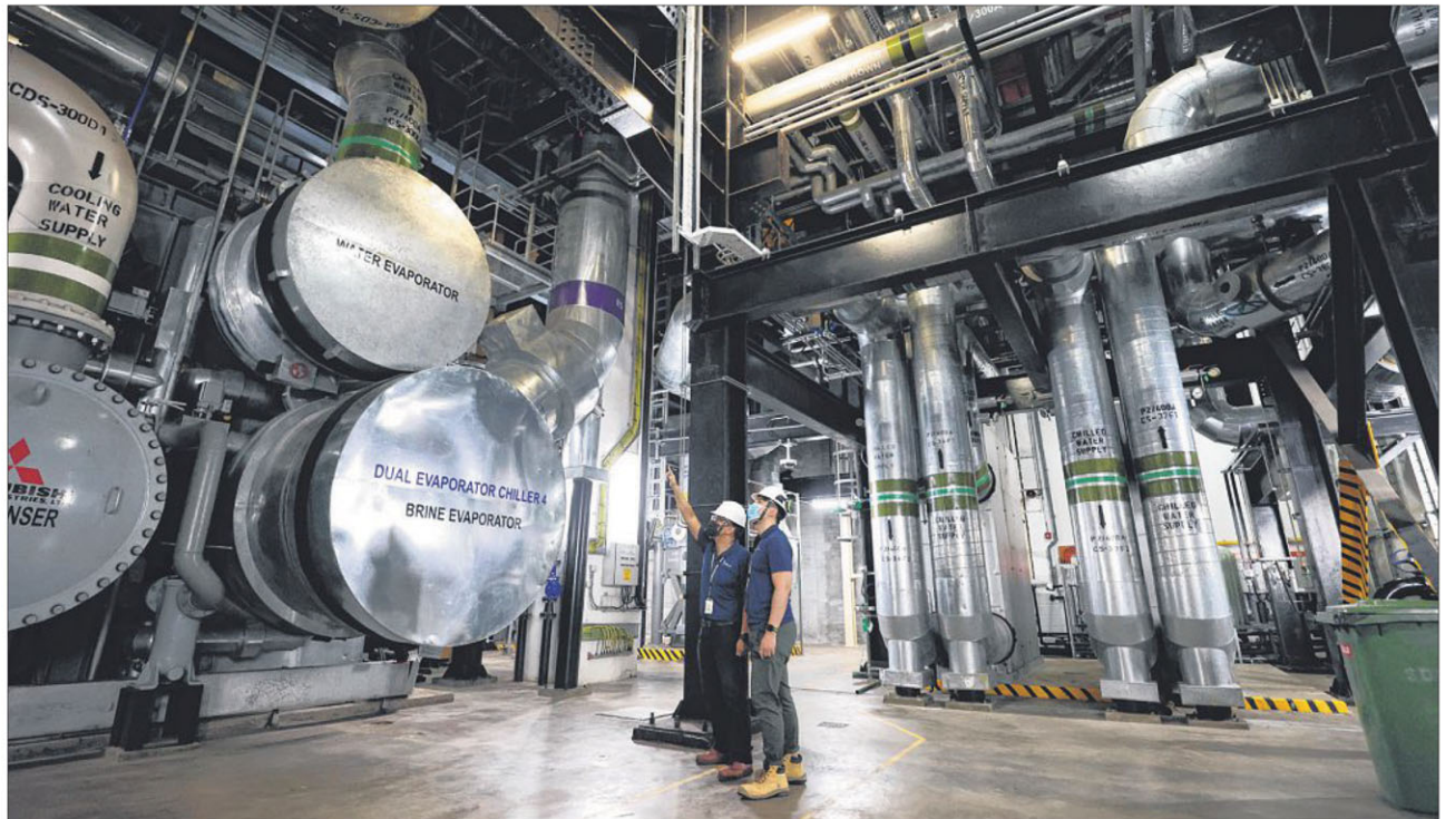
采纳区域供冷系统的建筑业主能获额外的总楼面面积作为奖励。图为滨海湾金沙所衔接的滨海湾区域供冷网络是全球最大地下供冷网络。（档案照片）
