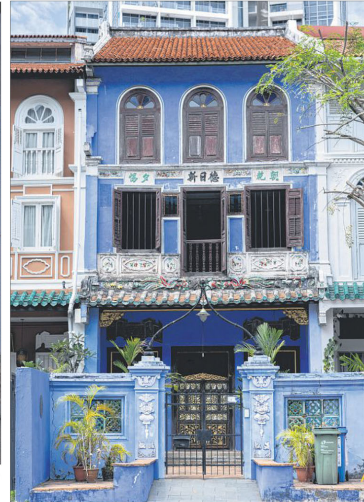
峇峇屋的屋内和屋外有多处裂缝和壁癌，国大在正式修复前已经聘请了建材原料专家对建筑进行勘察和研究，探测墙内的温度、湿度等，并用小面积实验的方式来研究最适合用来修补建筑原材料石灰灰泥的建材。（特约李姿仪摄）
